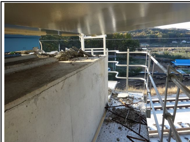
교각 P1 폐콘크리트 퇴적
