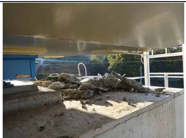
교각 P1 폐콘크리트 퇴적
